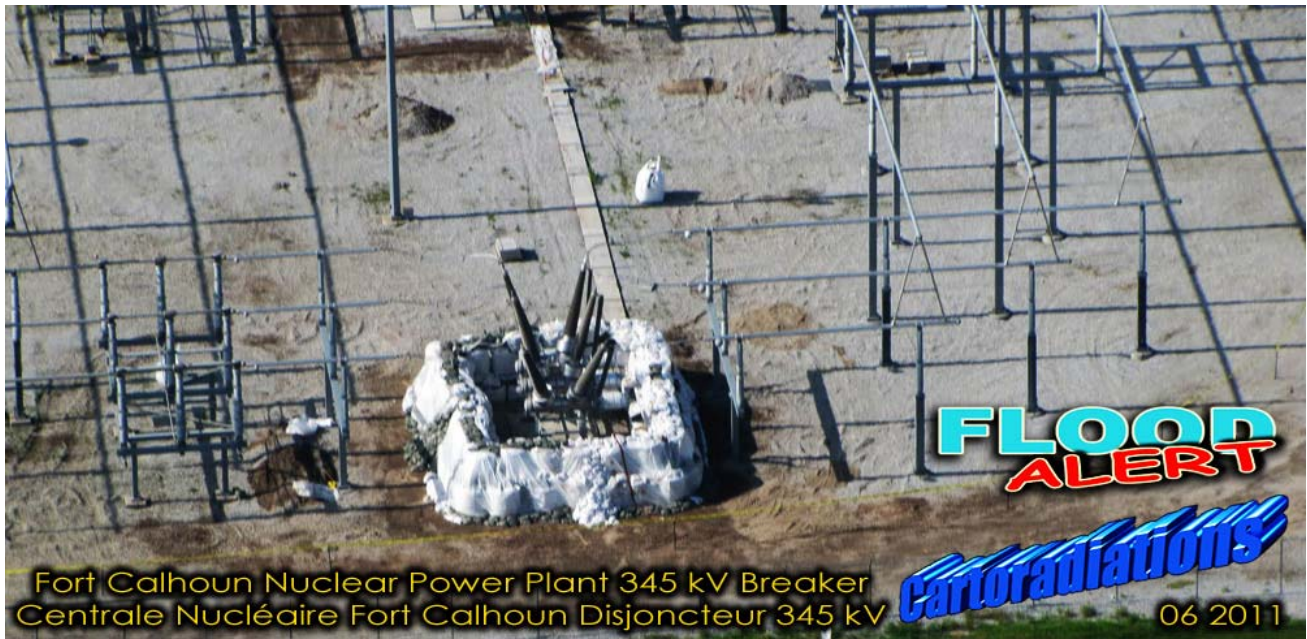
Fort Calhoun Nuclear Power Station : Breaker 345 kV Protection (sandbags!) Centrale Nucléaire de Fort Calhoun : Protections Disjoncteur 345 kV (sacs de sable !)
